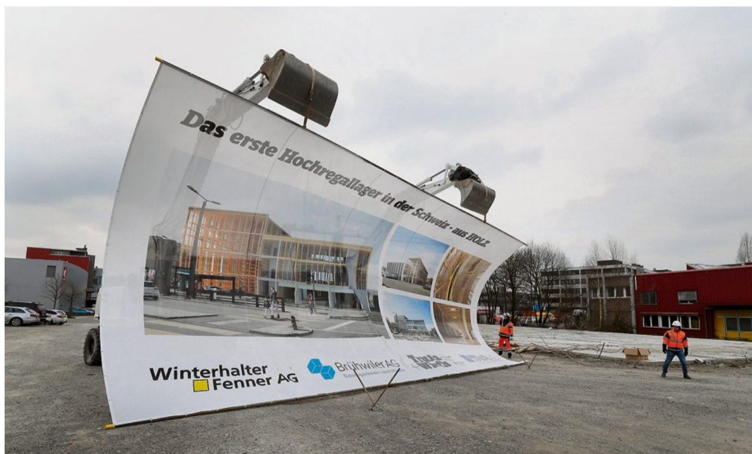
Im Industriegebiet Herti erfolgte gestern der Spatenstich zum ersten Schweizer Hochregallager, das aus Holz gebaut wird. Foto: Balz Murer
