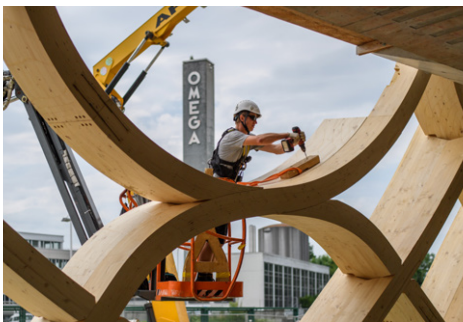
Stellvertretend für das hohe Know-how Schweizer Holzbauten: Arbeiten an der Holzgitterschale des neuen Verwaltungsgebäudes der Swatch Group in Biel.
